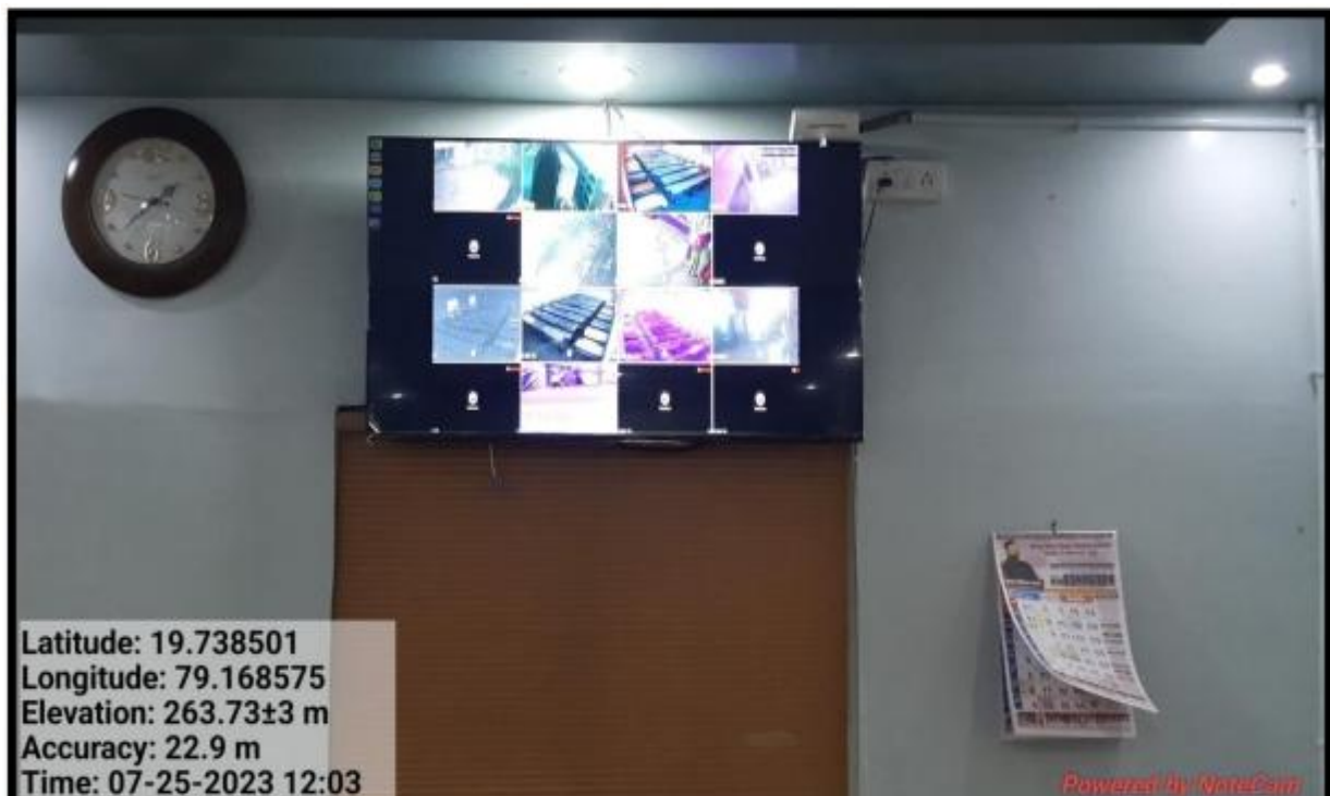
CCTV DISPLAY UNIT
